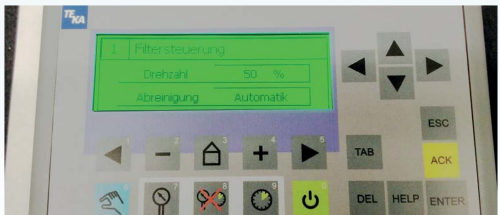
Unidad de control S7 de Siemens integrada
